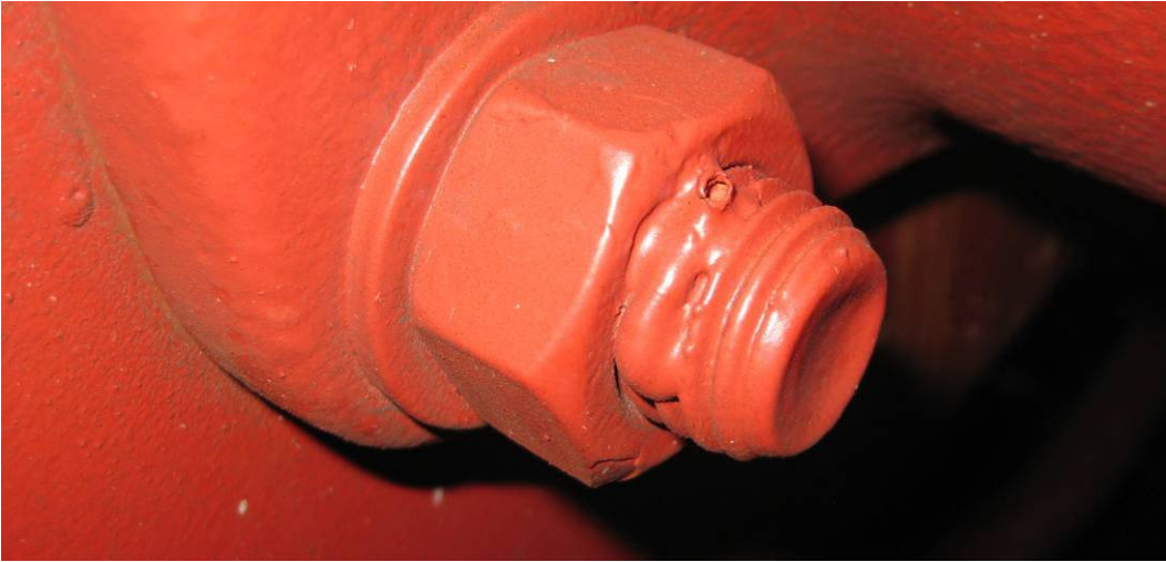
Bild 3: Nicht normgerechte Schweißpunktsicherung.
