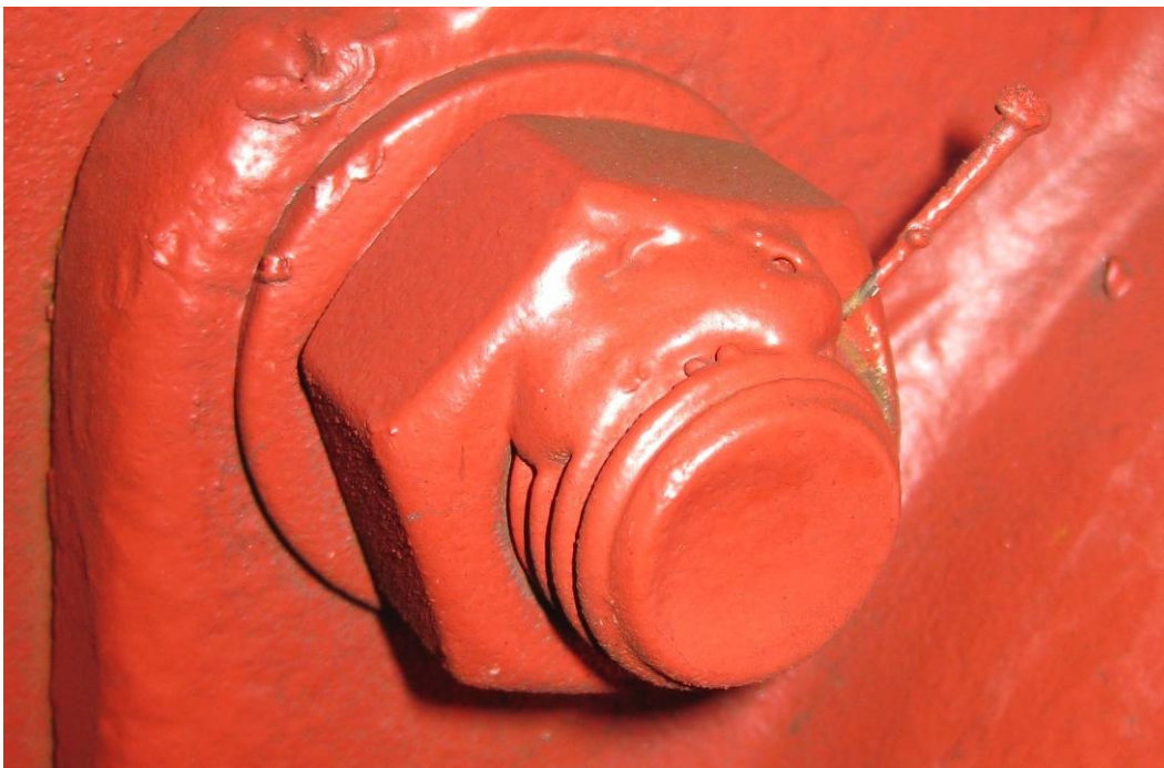
Bild 2: Nicht normgerechte Schweißpunktsicherung, hier mit Schweißdraht.
