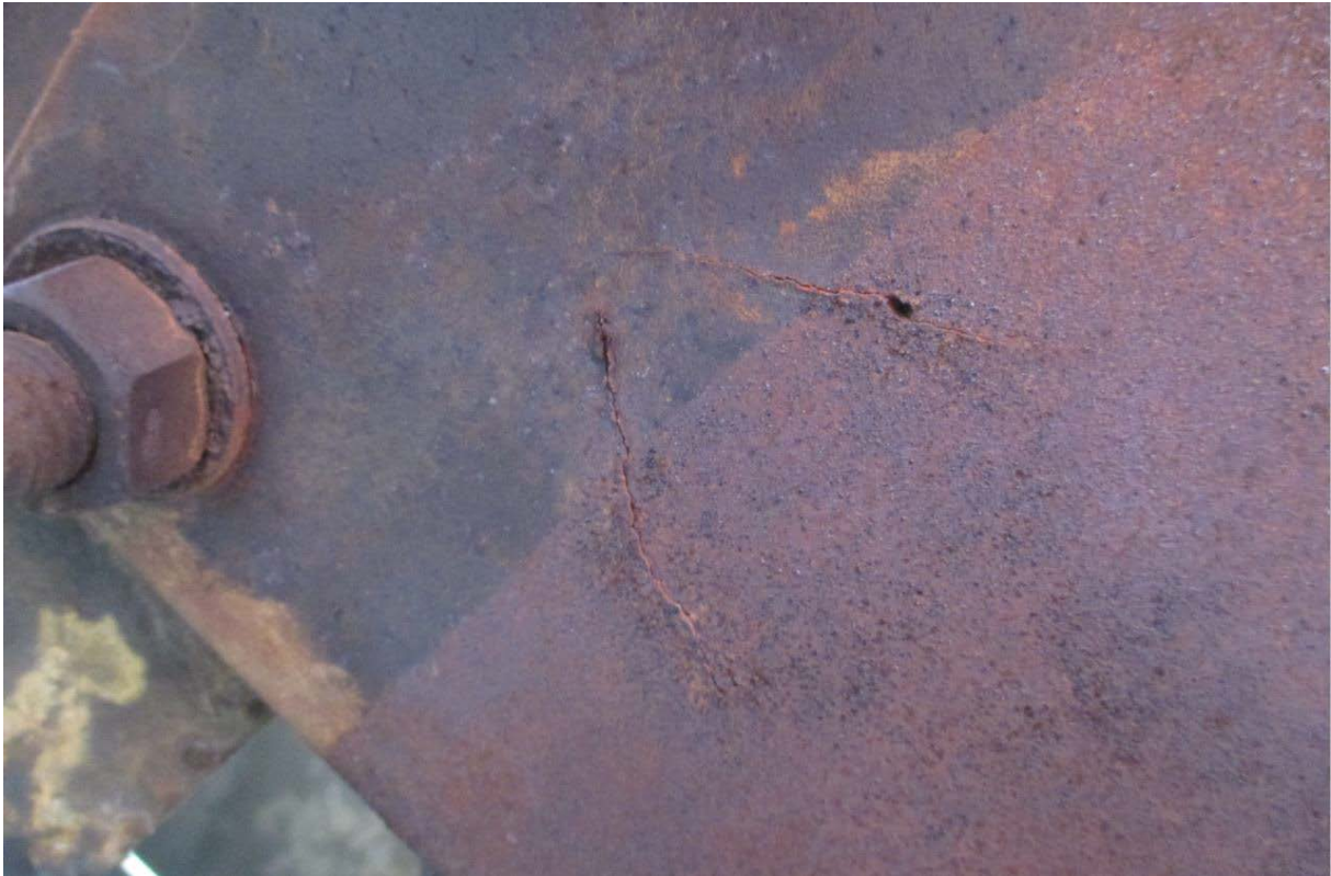
Bild 1: sichtbare Risse an der unteren Grundplatte des Stützlagers
