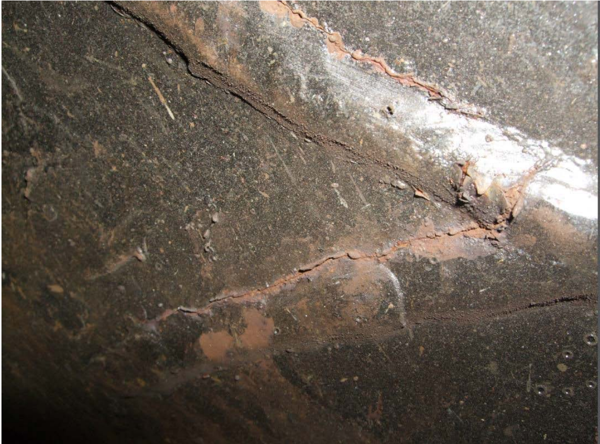
Bild 3: sichtbare Risse neben Reparaturschweißnaht
